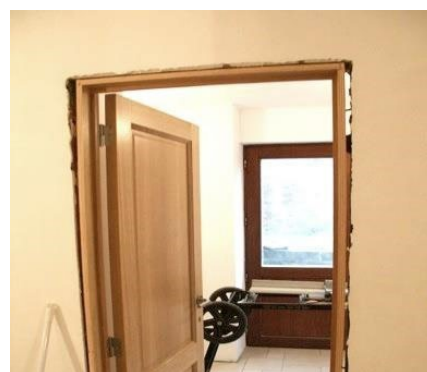
Figure 42 : Mauvaise liaison maçonnerie / chambranle
