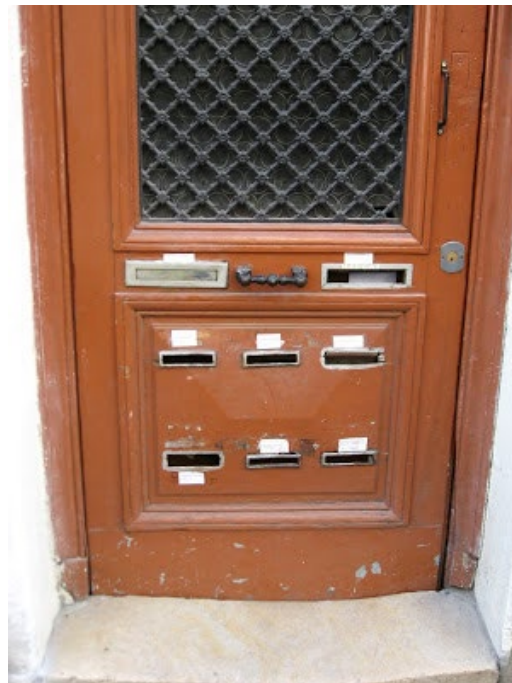
Figure 47 : Boîtes aux lettres multiples = fuites acoustiques multiples
