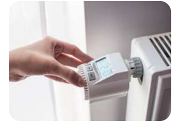
Vanne thermostatique programmable
