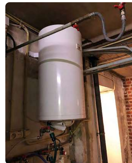
Ballon électrique de 200 litres
