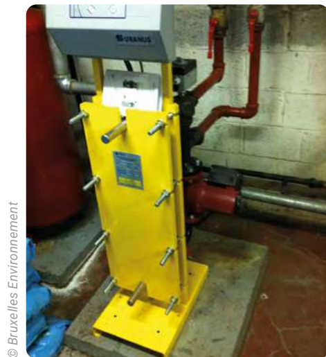
Échangeur à plaques
