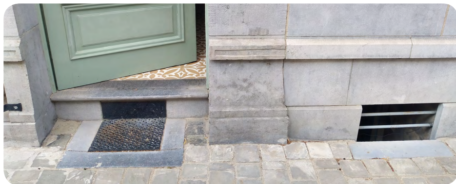
Soupirail et ouverture pour assurer une bonne ventilation
