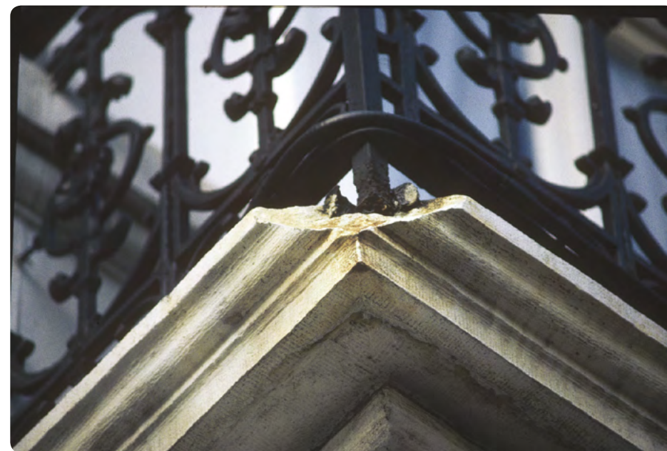
Le gonflement du métal sous l'effet de la rouille, combiné au gel, provoque des cassures dans la pierre.
