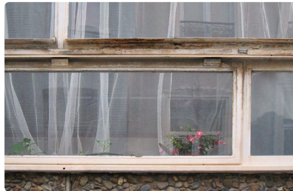
Rouille sur les traverses inférieures : entretien urgent !
