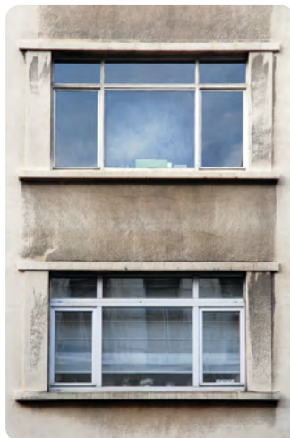
Châssis en acier remplacé par un châssis en PVC sans rapport avec le modèle d'origine
