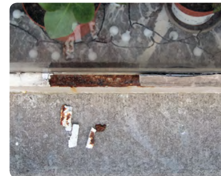
Mastics dégradés: entretien urgent !
