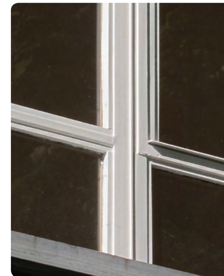
Châssis en acier dans un immeuble des années 1950 Rue de l'Aurore 1a, 1050 Ixelles
