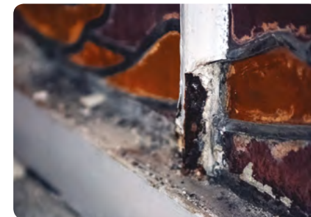
Oxydation du châssis métallique © J.-M. Gdalewitch
