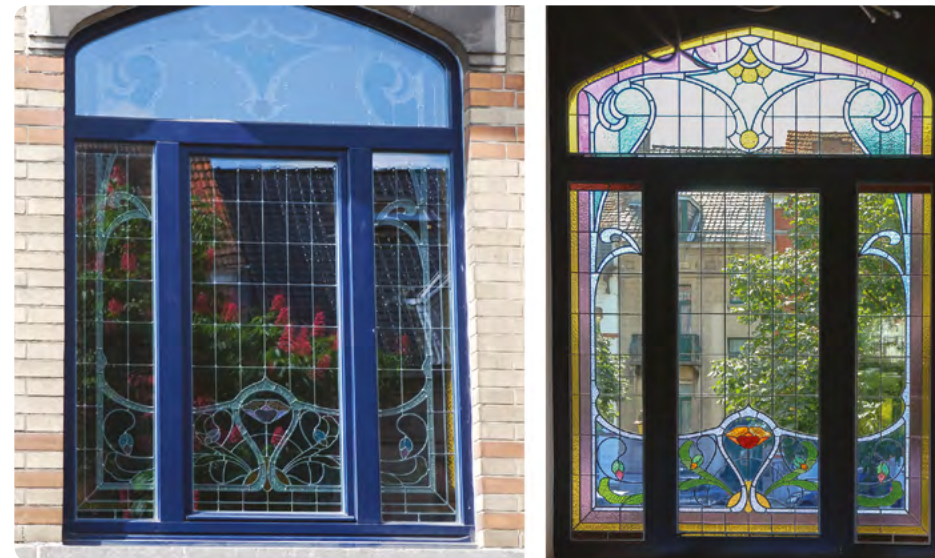
Le châssis d'origine était irrécupérable. Le vitrail a été posé par l'intérieur contre le double vitrage du nouveau châssis.
