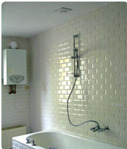
Un chauffe-eau à ventouse assure l'alimentation en eau chaude (notez l'extracteur électrique au-dessus de la baignoire).
