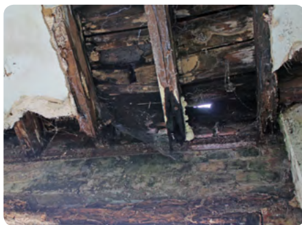
Développement de champignons dans la structure de la plateforme à la suite d'infiltrations
