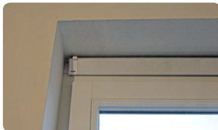
Grille d'amenée d'air
