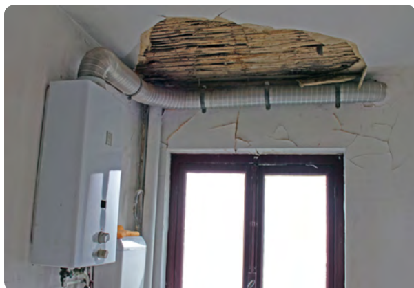
Évacuation des gaz brûlés non conforme
