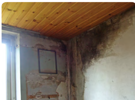
Problème de condensation sur le mur froid d'une annexe
