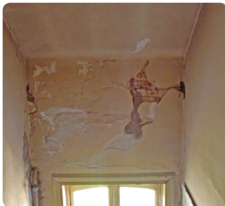
Dégradation des maçonneries et des plafonnages suite à des problèmes d'infiltration
