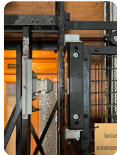
Serrure positive sur une grille rétractile palière vue de l'extérieur de la gaine
