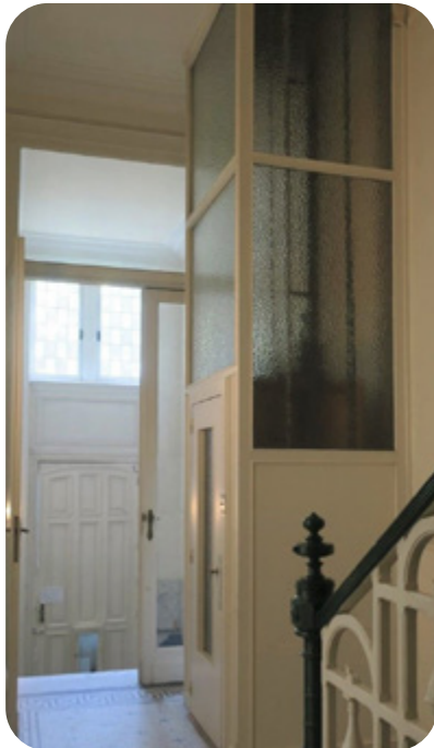
Film protecteur sur les parois vitrées de la gaine fermée
