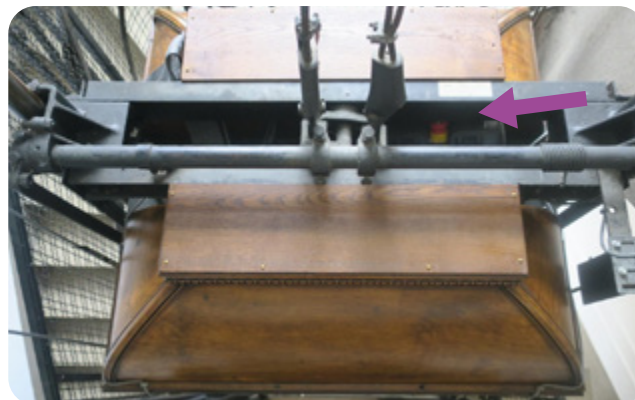
Intégration de la commande d'inspection dans le toit de la cabine
