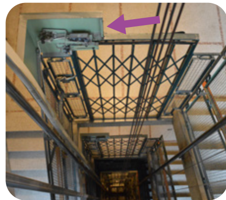
Protection du système de déverrouillage vue depuis la gaine
