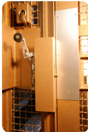
Serrure positive sur une porte palière battante vue de l'intérieur de la gaine
