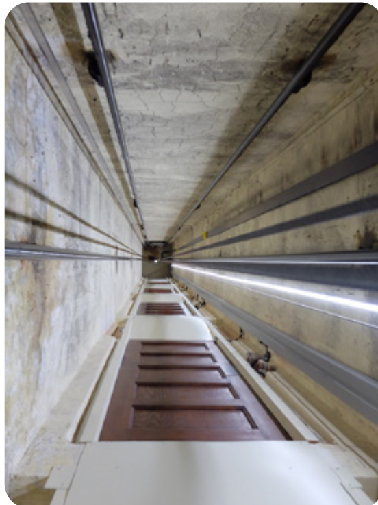
Fine bande LED en continu sur toute la hauteur de la gaine
