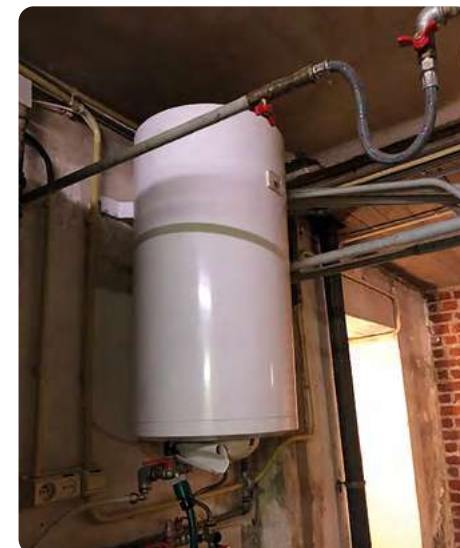
Elektrische boiler van 200 liter
