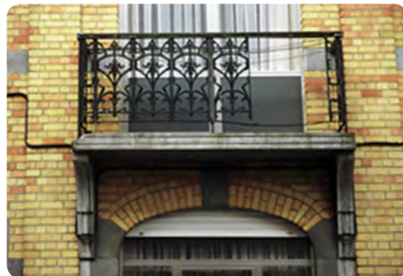
Balkon met gietijzeren borstwering waarvan twee elementen gebroken zijn
