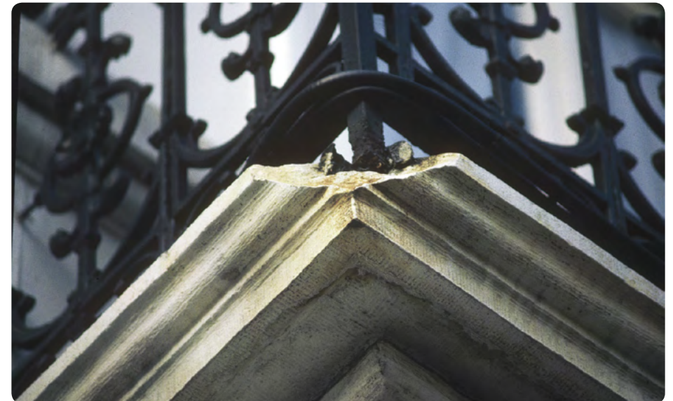
Het zwellen van het metaal door inwerking van roest, in combinatie met vorst, veroorzaakt breuken in de steen.
