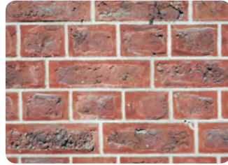
Geverfde metselstenen met geborstelde voegen die opnieuw getrokken zijn met het voegijzer
