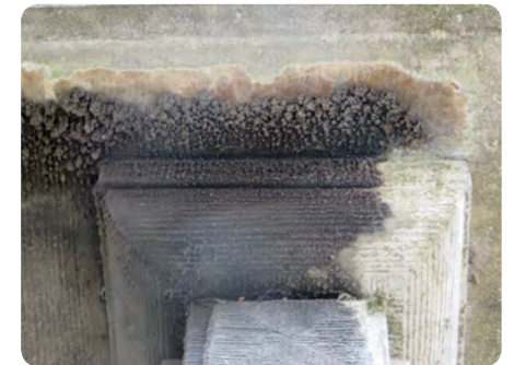
Pathologische aankorsting onder een balkonplatform in blauwe hardsteen
