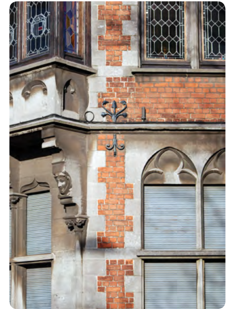
Ongelijke verdeling van vuil op de gevel Ooststraat 2, 1030 Schaarbeek
