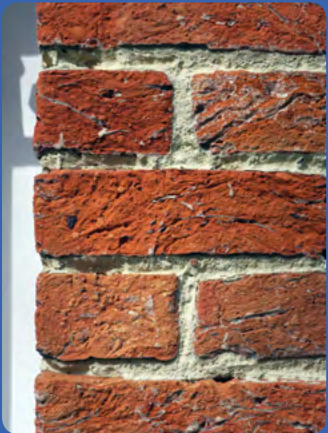
Geërodeerde baksteen door een agressieve reiniging
