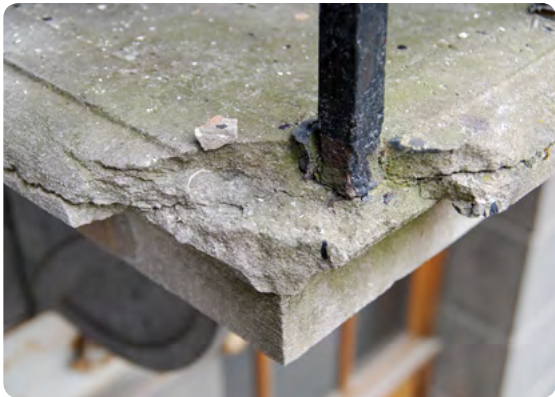
Te restaureren hoek van het balkonplatform
