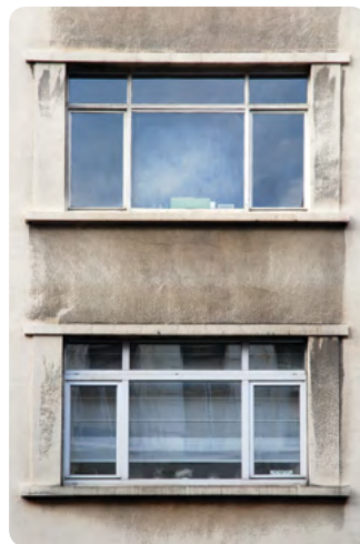
Stalen raam vervangen door raam in PVC zonder overeenkomst met het oorspronkelijke model
