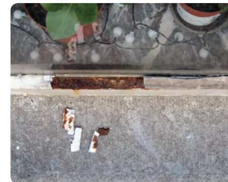
Beschadigde stopverf: dringend onderhoud noodzakelijk!
