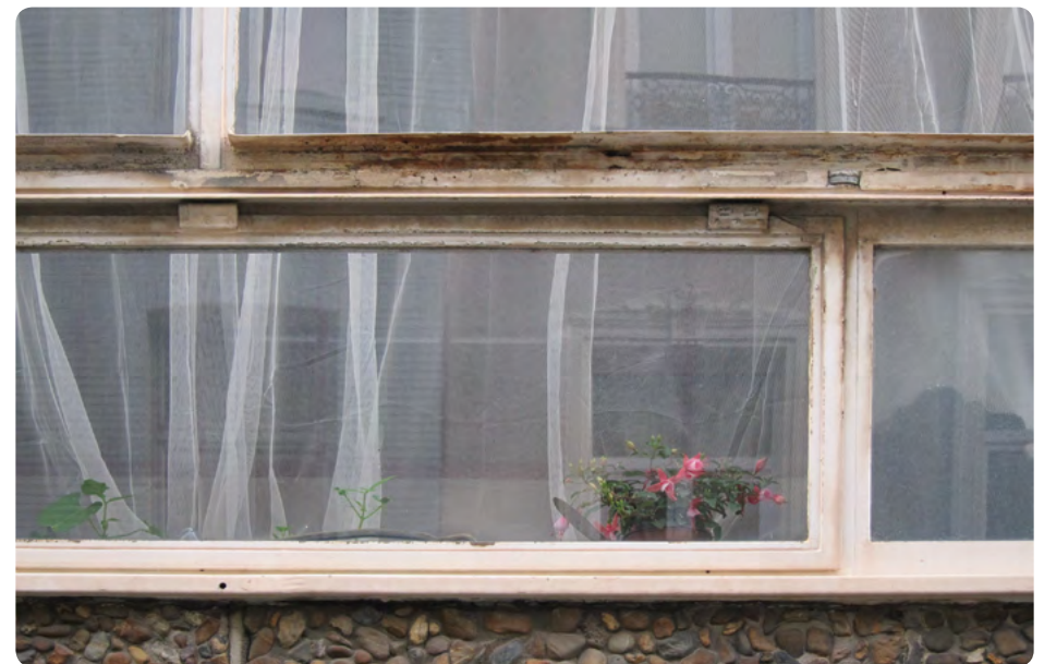
Roest op de onderste dwarsregels: dringend onderhoud noodzakelijk!
