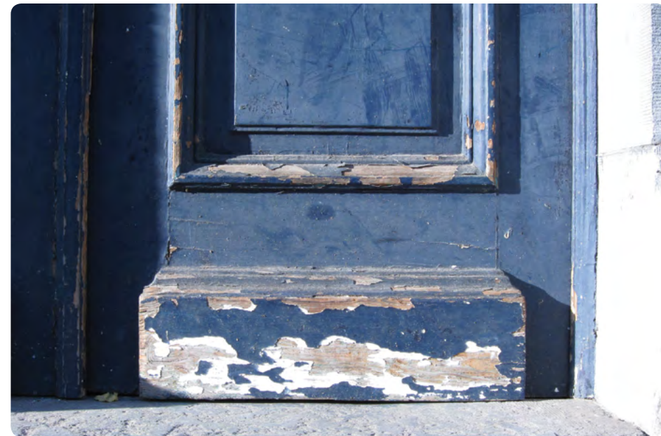
Afgebladderde verf onderaan de deur
