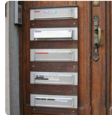
Onesthetische openingen van brievenbussen, oorzaak van koude luchtinfiltratie.
