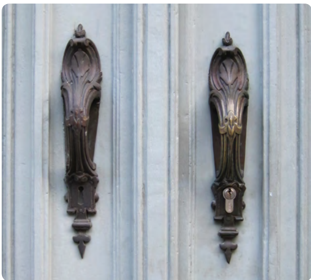
Oud slotwerk waarvan het sleutelgat vergroot werd voor het plaatsen van een cilinder
