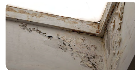
Afbladderende verf op de omlijsting van een koepel met plat dak door een slechte afdichting tussen de koepel en het platte dak
