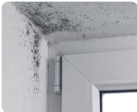
Condensatie rond een raam door de aanwezigheid van een koudebrug en een gebrek aan ventilatie in de ruimten
