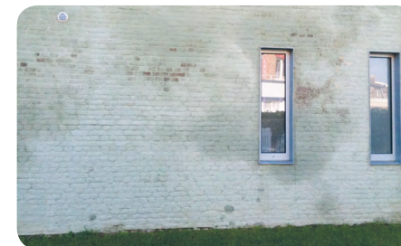
Vochtplek op de gevel door de aanwezigheid van nitraten in het metselwerk © WTCB-Digest nr. 13 van 2016 (TV Recap-13)
