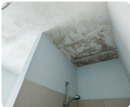
Condensatie op het plafond van een slecht geventileerde badkamer veroorzaakt schade en schimmel
