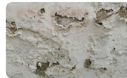
Verfgeschade door zouten
