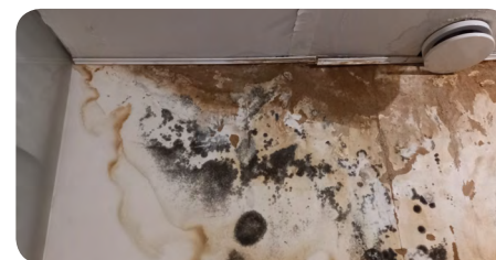
Donkere kringen op de muur van een ruimte onder een plat dak door een oude en geperforeerde dakafdichting
