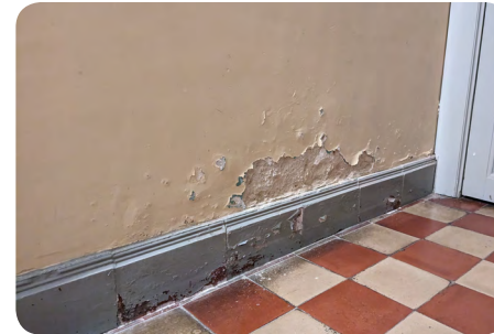
Opstijgend vocht leidt tot aantasting van pleisterwerk en verfwerk op een muur op de begane grond zonder kelder
