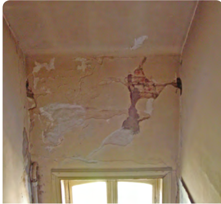
Beschadiging van het metselwerk en de bepleistering ten gevolge van waterinfiltratie
