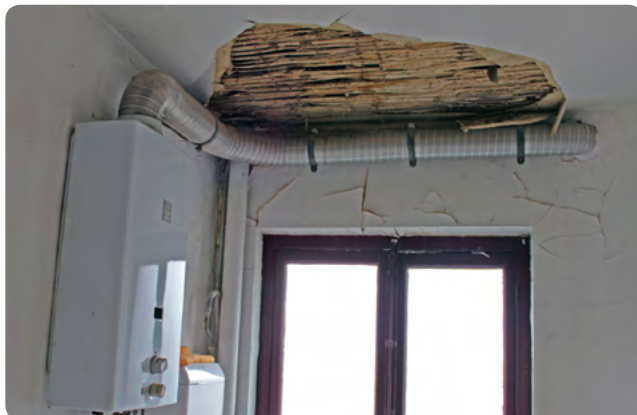
Niet conforme afvoer van verbrandingsgassen
