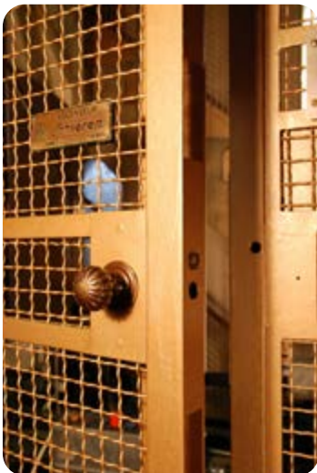
Positieve vergrendeling op een vleugel deur van een bordes gezien van buiten de schacht
