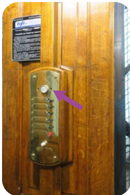
Bidirectionele communicatie verbonden aan de alarmknop van de oorspronkelijke besturingskast
