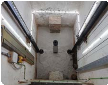
Plaatsing in de put van ledstroken en een buffer onder de liftkooi
