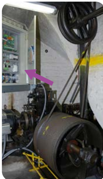
Nieuwe bedieningskast met behoud van de oude machinerie-elementen
