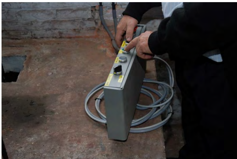
Inspectiekast in de machinekamer
