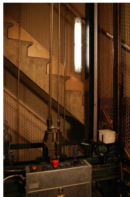
Verlichting van de schacht
