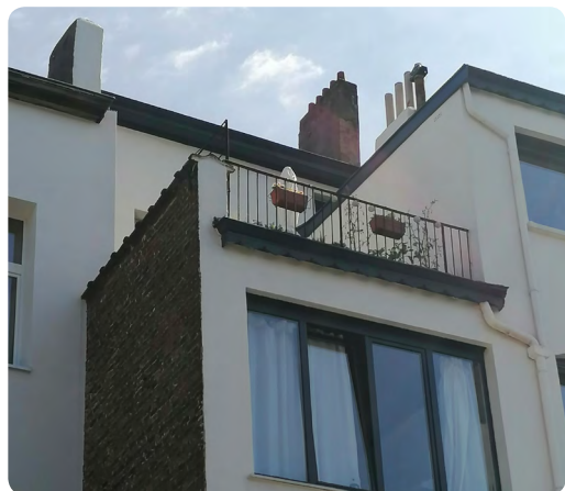
Terras dat niet voldoet aan de eisen van het nieuwe Burgerlijk Wetboek. Aan de linkerkant wordt de afstand van 1,90 m vanaf de perceelsgrens niet nageleefd.
