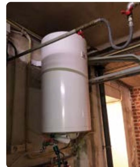
Elektrische boiler van 200 liter
