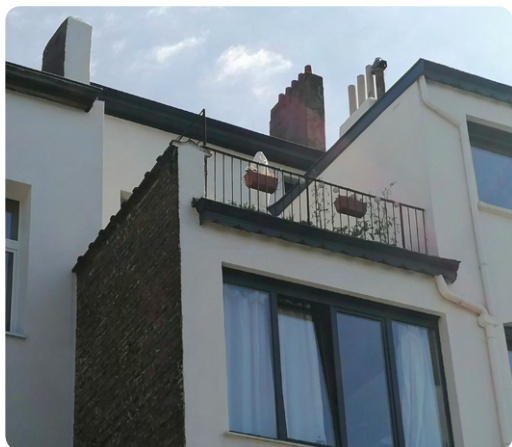
Terrasse ne répondant pas aux impositions du nouveau Code civil. En effet, du côté gauche, la distance de 1,90m par rapport à la limite de la parcelle n'est pas respectée.
