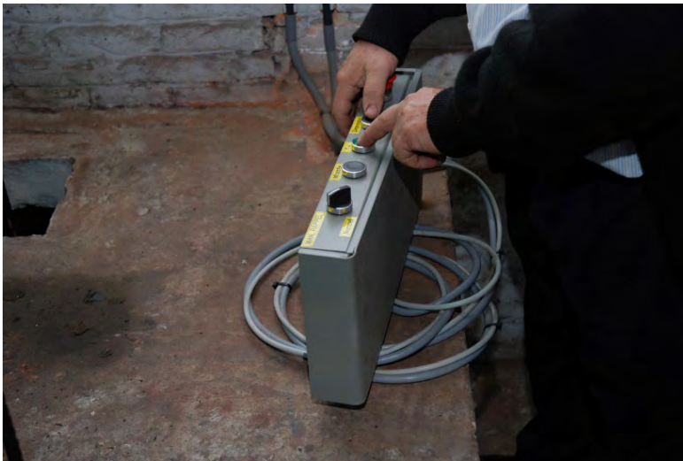
Boîte d'inspection dans la salle des machines
