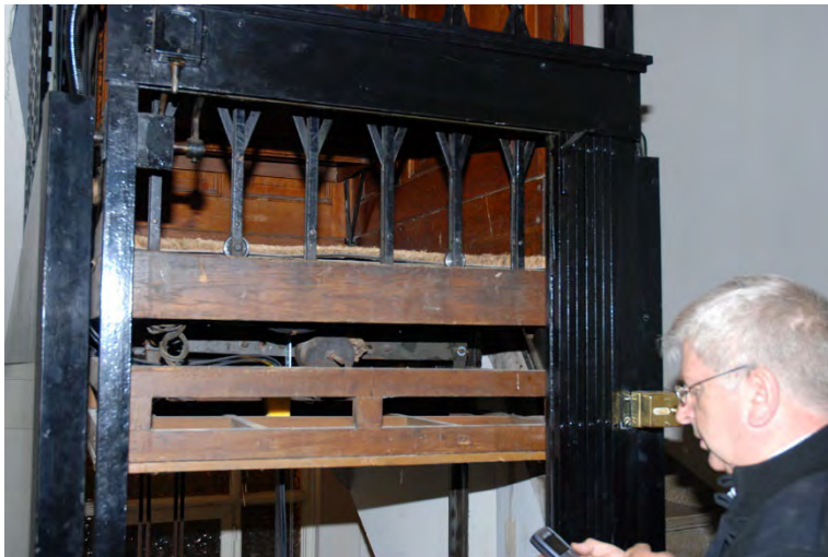
Dispositif de sécurité d'origine sous le plancher de la cabine
