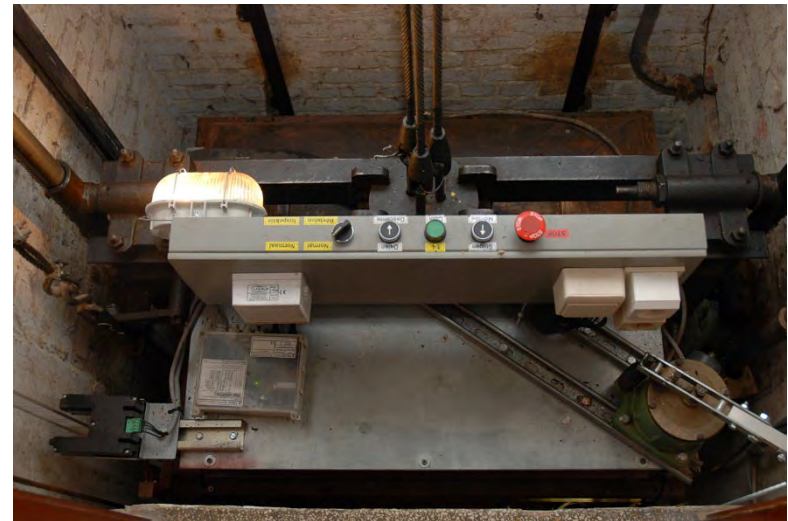
Boîte d'inspection sur le toit de la cabine
