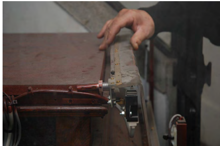
Dispositif de sécurité récent sur le toit de la cabine (Atelier Marien)
