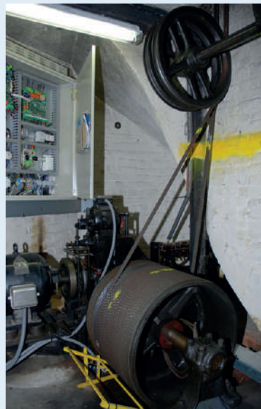
Installation d'une nouvelle armoire de commande dans un bâtiment situé rue Forestière à Bruxelles [© Jérôme Bertrand].
