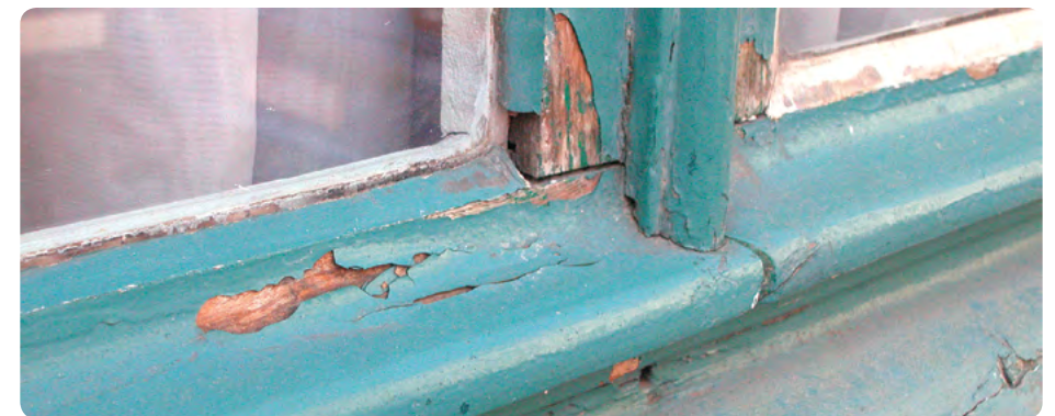
Beschadigd schilderwerk en stopverf: dringend onderhoud noodzakelijk!
