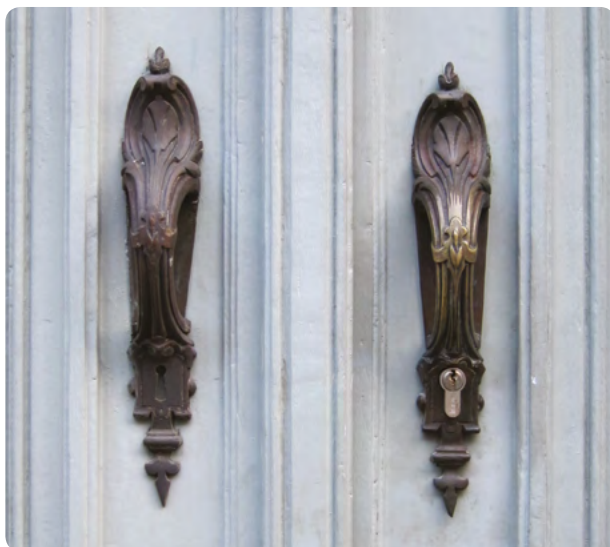
Garniture de serrure ancienne dont le trou de clé a été agrandi pour la pose d'un cylindre
