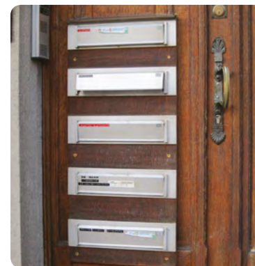
Percement inesthétique de boîtes aux lettres, cause d'infiltration d'air froid
