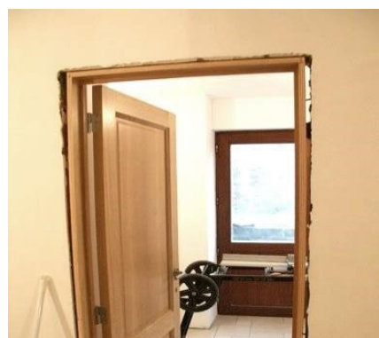
Figuur 42 : Slechte verbinding metselwerk / kozijn
