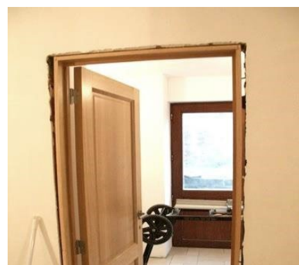
Figuur 42 : Slechte verbinding metselwerk / kozijn
