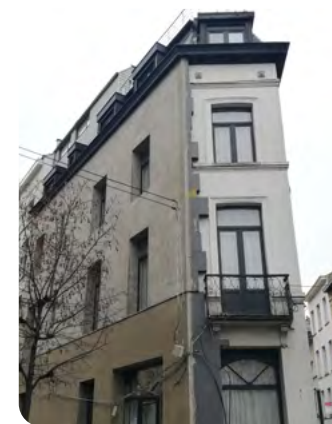
Isolation par l'extérieur sans égard pour l'esthétique de la façade
