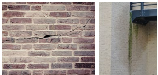
Voorbeeld: scheur en abnormale watervlekken
