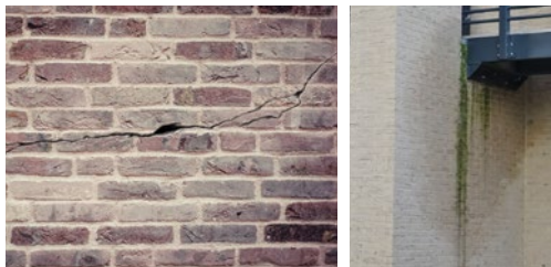
Exemple : Fissure et coulées d'eau anormales
