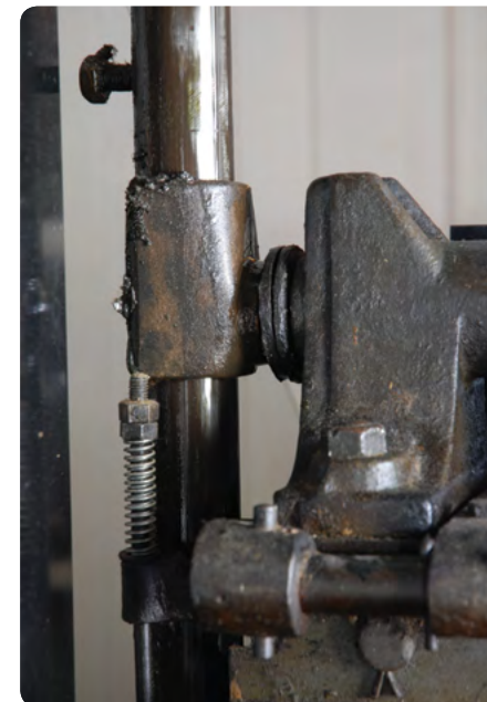
De vanginrichting: dit veiligheidssysteem, vanaf 1853 door Otis ontwikkeld, verhindert dat de liftkooi valt bij een kabelbreuk
